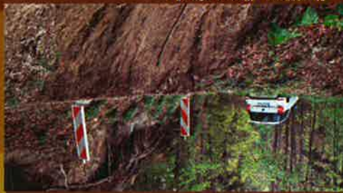
Plaz, ki je porušil cesto v Šnoviklu.
